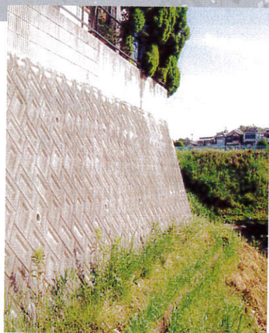
擁壁の上で敷地をかさ上げてブロックを土留めにして住宅。ブロックは擁壁に緊結していない。不同沈下を起こした例（写真：住宅保証機構）
