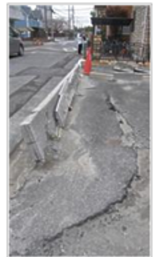
液状化現象でひびの入った駐車場。周囲の家は 人けが少なく、警察官が巡回連絡を行っていた = 4月9日、千葉県浦安市今川
